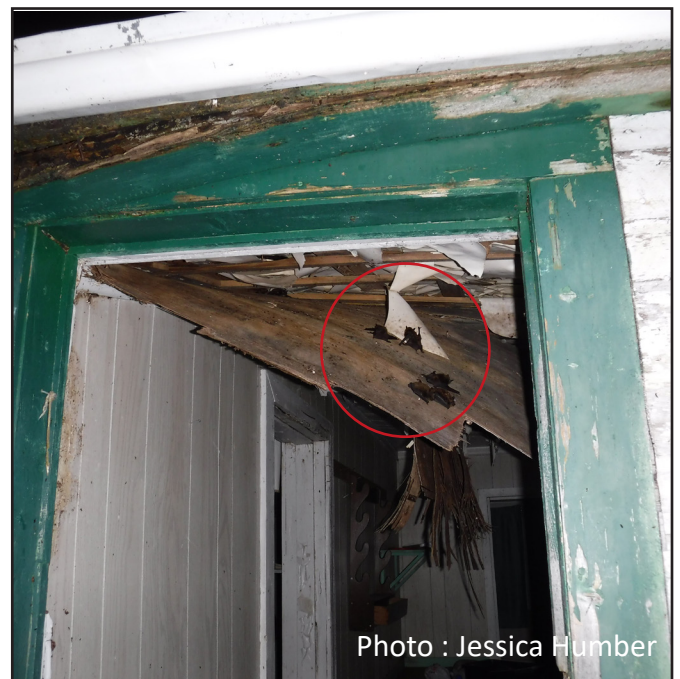
Figure 43. Certains bâtiments doivent être démolis pour garantir la sécurité publique ce qui ne permet pas aux chauves-souris de rester.
